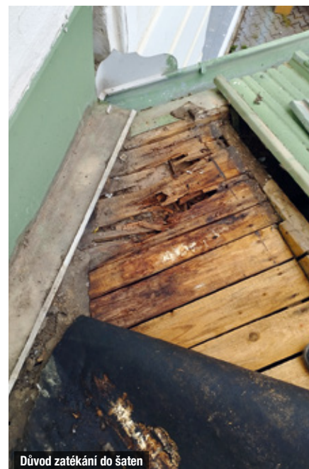
Důvod zatékání do šaten
